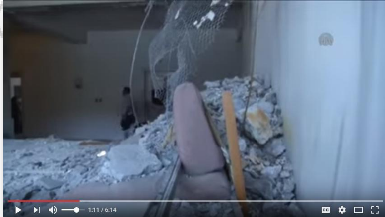
Şekil 34 Hasarlı çatının alttan görünüşü ve içerideki durum
