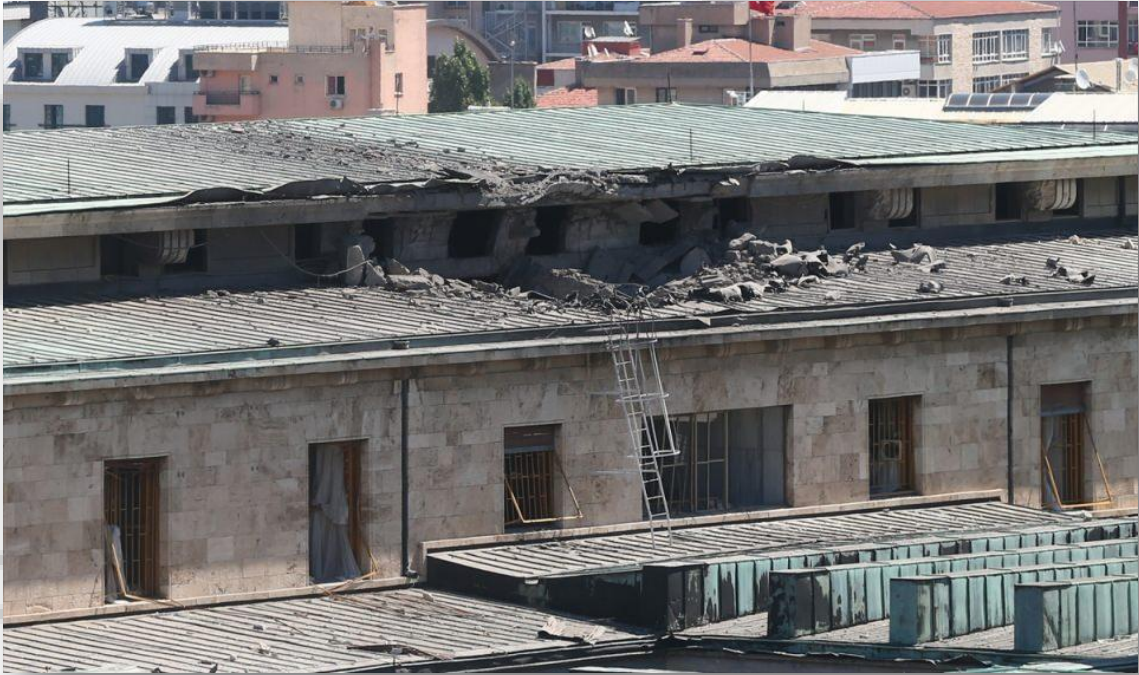
Şekil 33 Meclis çatısında ikinci hasarlı bölüm
