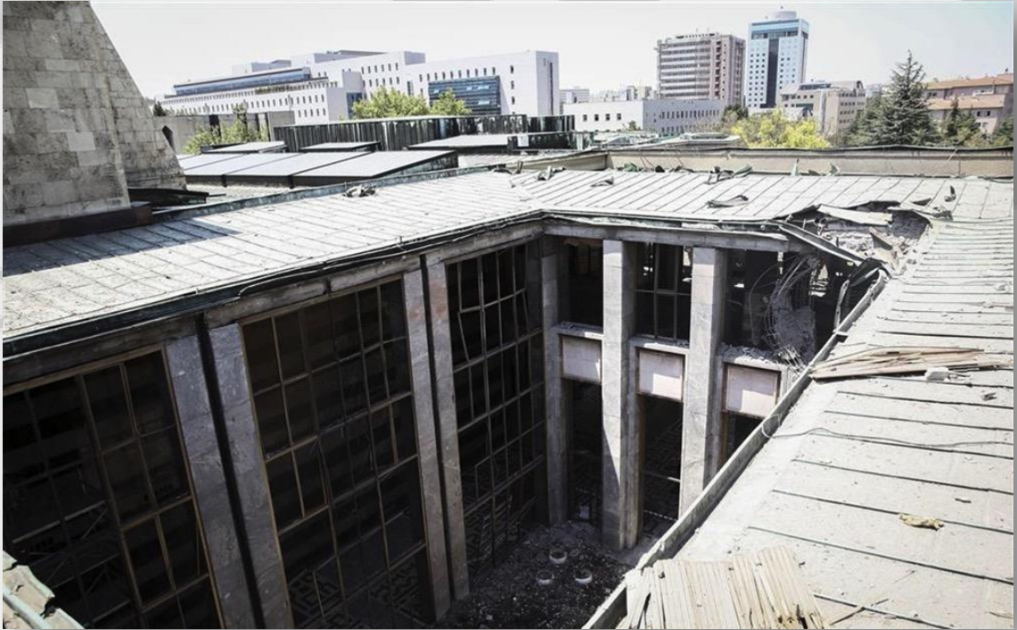
Şekil 30 Meclis çatısındaki ilk hasarlı bölüm
